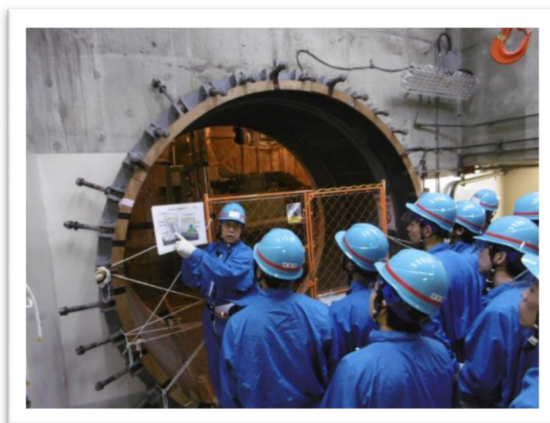
（原子炉格納容器入口付近）
