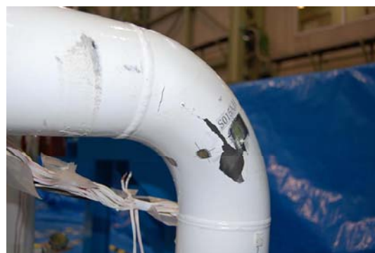
エルボ1の周方向き裂
