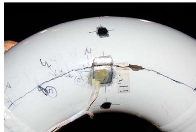
エルボ3下面の軸方向き裂
