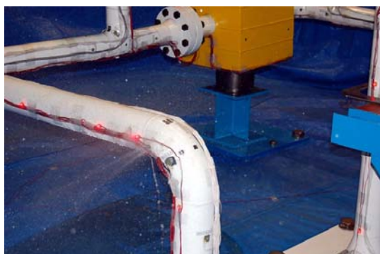
き裂貫通時の状況（エルボ1）
